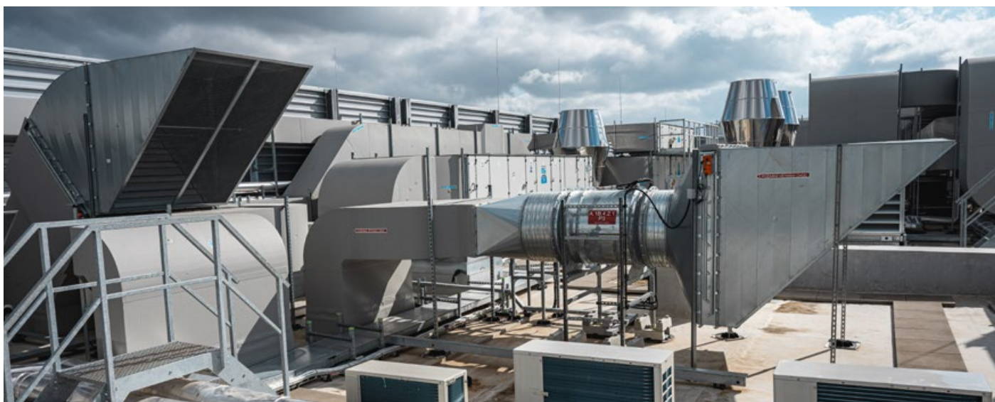
Celkem 9 000 m 2 předizolovaného potrubí, vybrané úseky opatřené povrchovou úpravou GumSkin.
